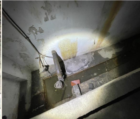
地下室集水井
